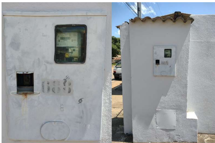
Figura 1 – Disjuntor Geral 120A
