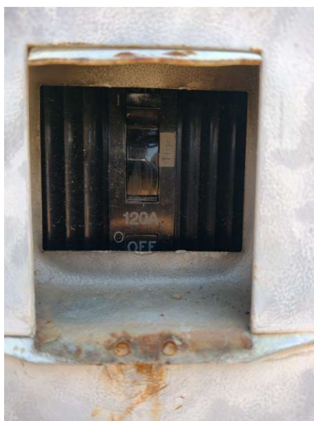
Figura 2 – Disjuntor Geral 120A
